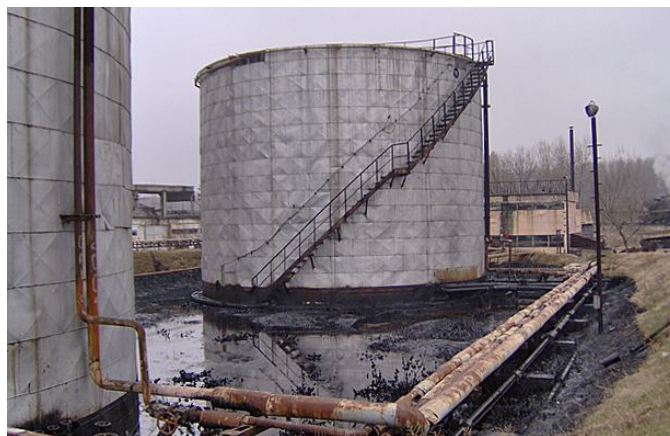
شکل ۱-۱ نشت نفت خام از مخازن نگهداری
